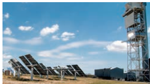
VISTA PARCIAL DE HYDROSOL II
